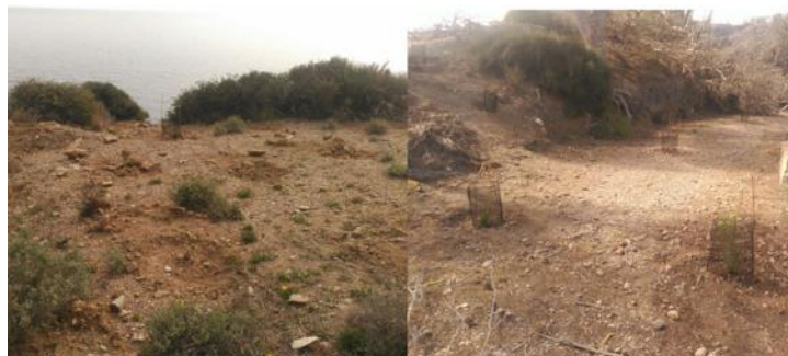
Sectores de plantación con hoyos durante el proceso de colocación de malla de protección en La Chapa y Cenizas
